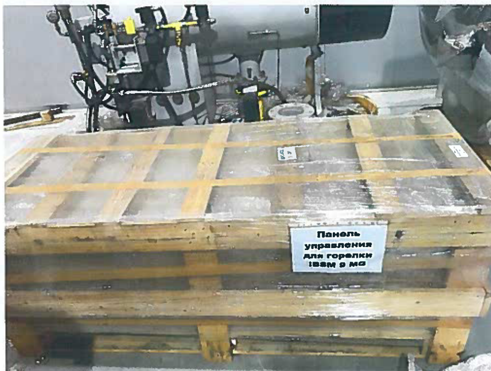
Фото 2 – Панель управления горелочным устройством
