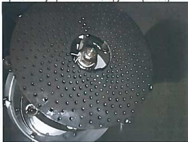
Фото 6 – Очаги коррозии на пламенной голове и форсунке отсутствуют
