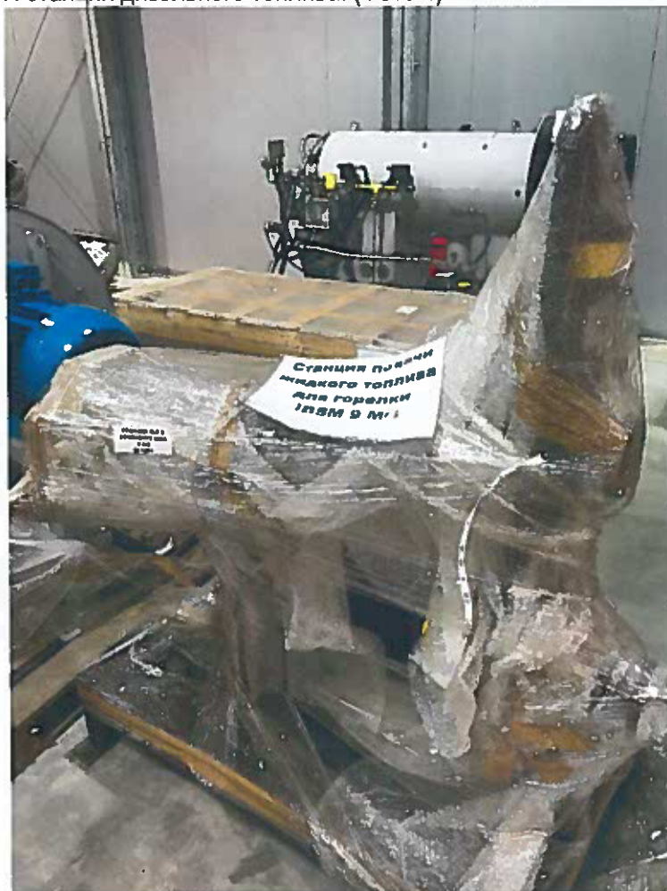
Фото 4 – Станция дизельного топлива
