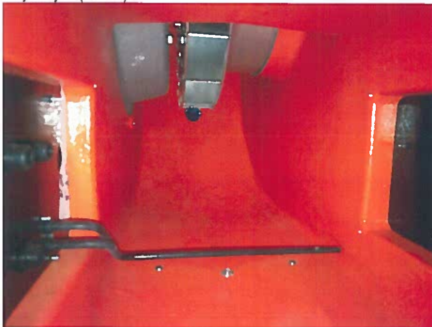
Фото 7- Вид на рабочее колесо вентилятора горелки
