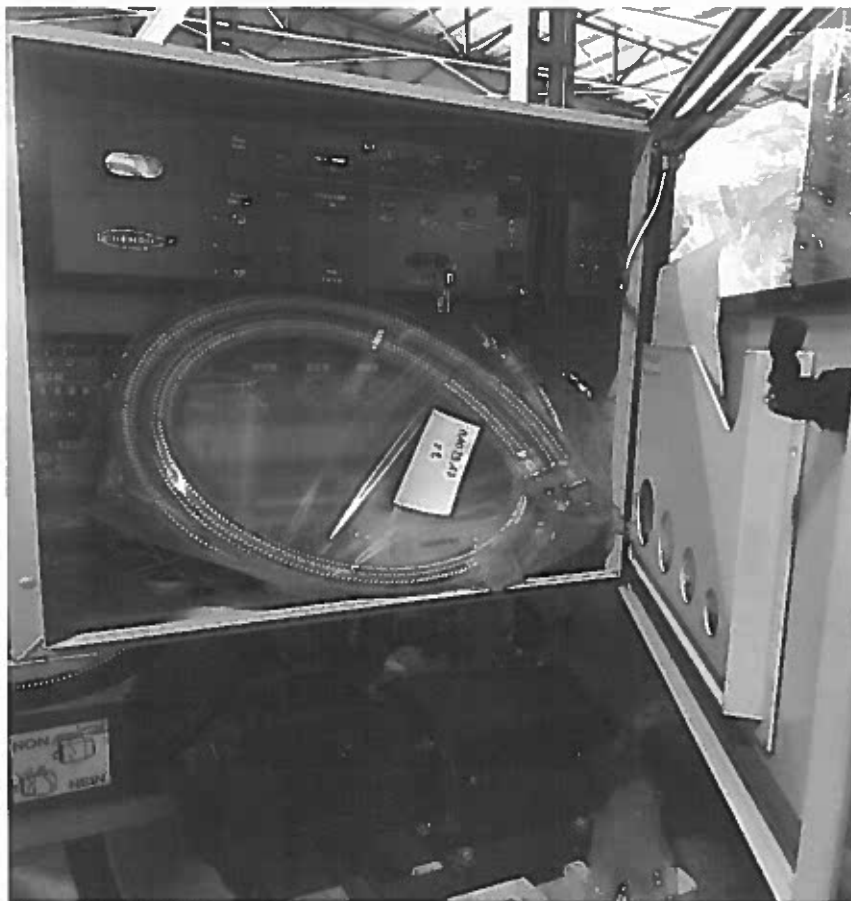
Фото 6 – Встроенный шкаф управления
