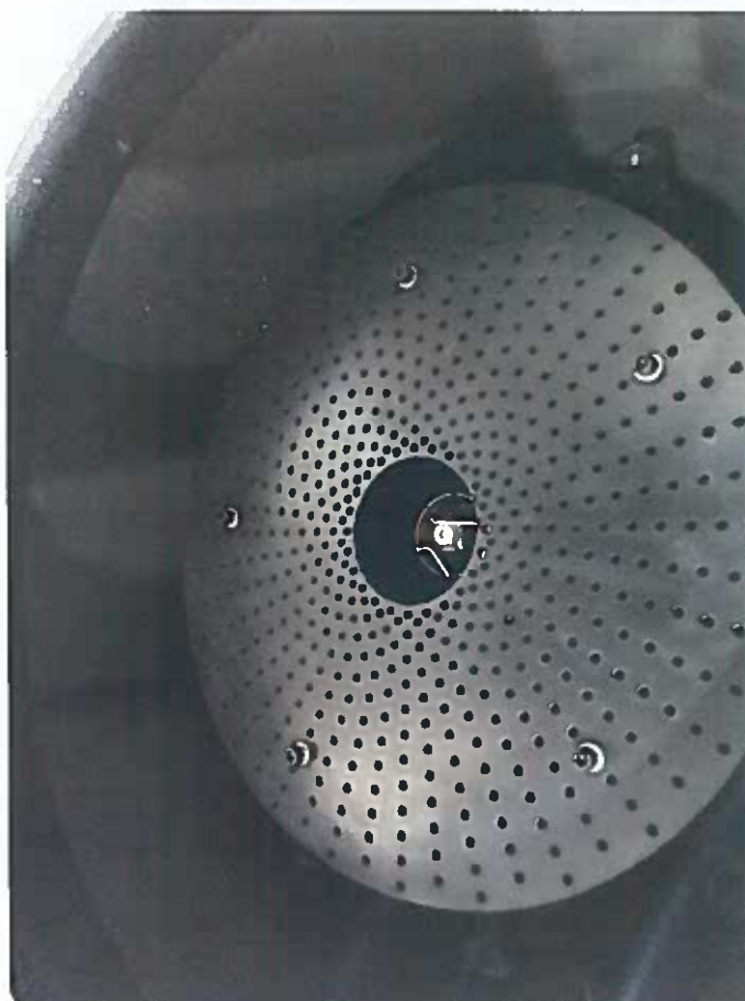
Фото 9 – Очаги коррозии на пламенной голове и форсунке отсутствуют
