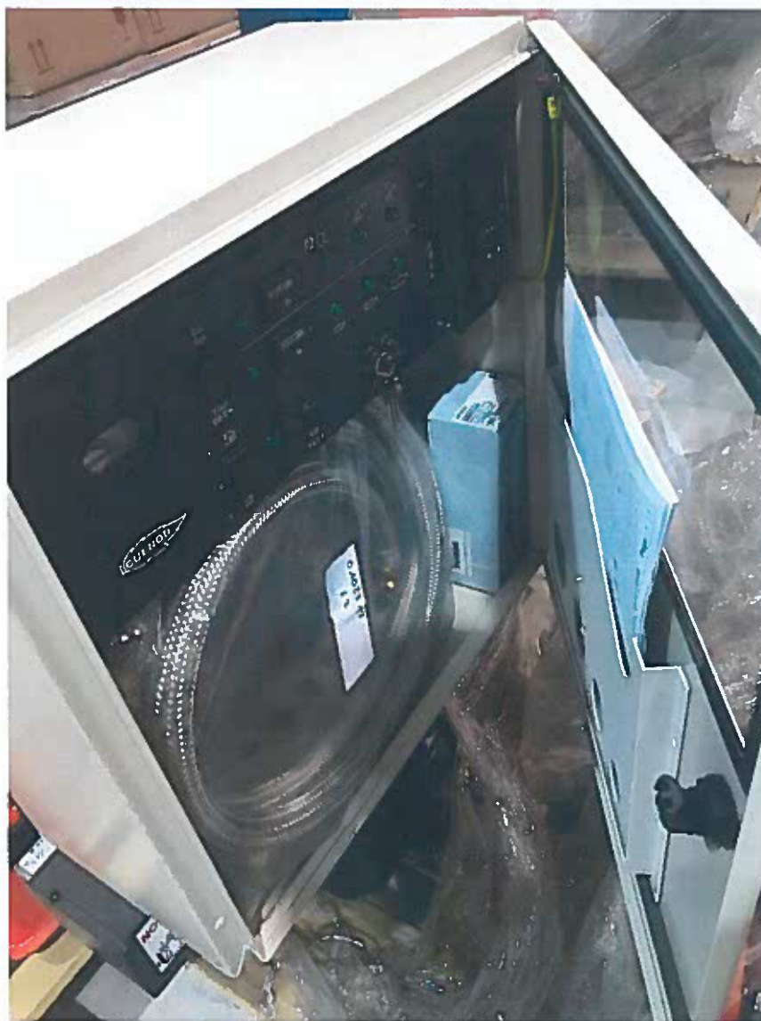
Фото 6 – Встроенный шкаф управления
